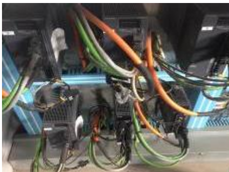
Figura 13 Fallas de tablero eléctrico principal mesa de corte plasma Fuente: Base de datos rep COTECMAR
