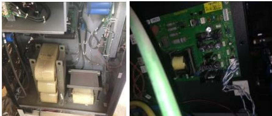
Figuras 11 y 12 Falla en la consola de selección y consola de dosificación
