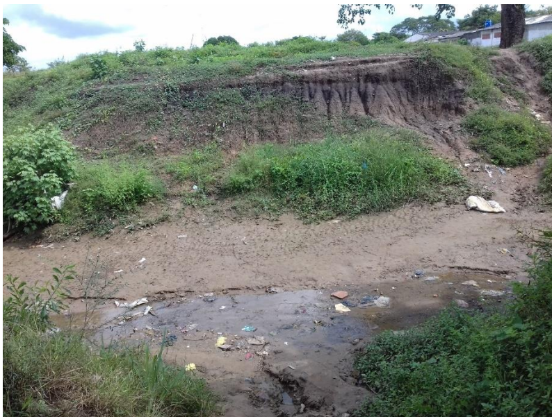
Fotografía 10. Ensanchamiento de sección transversal del arroyo, por erosión de taludes laterales del canal.
