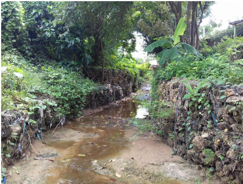
Fotografía 4. Muros de gaviones que conservan las secciones del canal en sector La Paz
