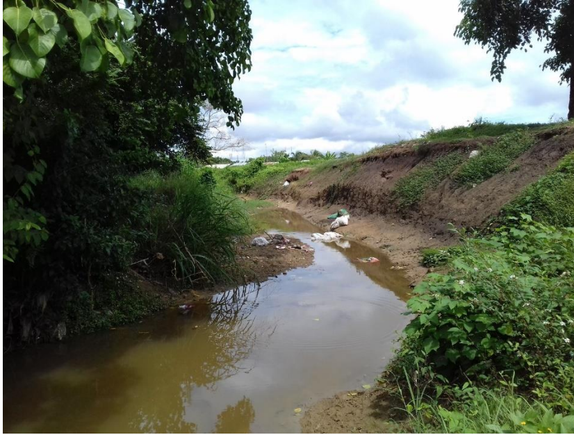
Fotografía 5. Aumento en la sección de tramo del canal ubicado en el sector La Paz, producto de caudales muy grandes en época invernal.
