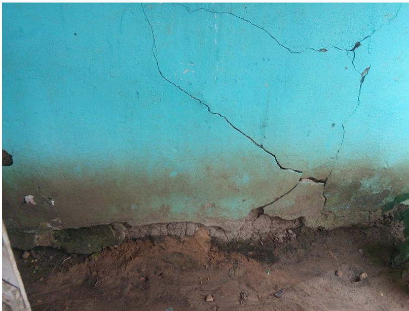
Fotografía 12. Manchas que muestran la altura alcanzada por el agua durante inundaciones en sector La Paz.
