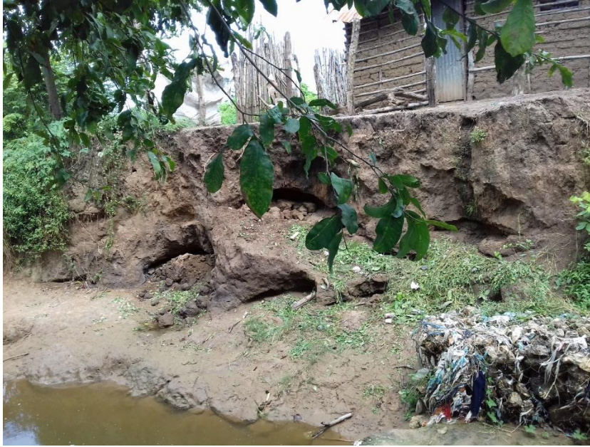
Fotografía 9. Socavación cerca de viviendas del sector La Paz
