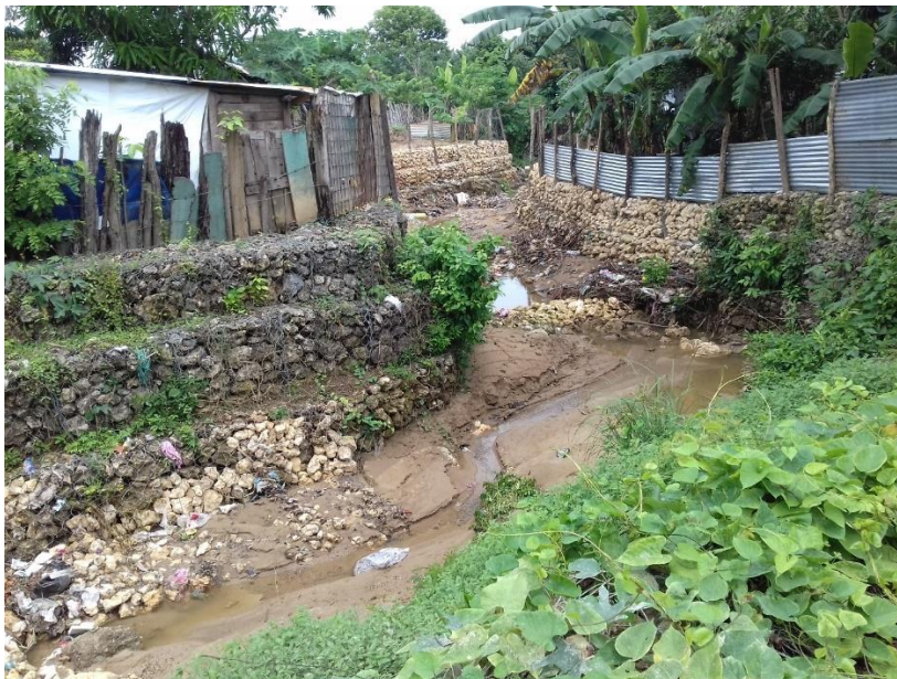
Fotografía 2. Muros de gaviones sobre tramo de arroyo Hormiguero con rebasamiento del cauce, Sector calle Franco.
