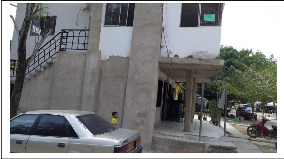
Anexo 4. Casa de esquina El Rodeo – sector 3 Mz 8, estado de daño de medio a alto.
