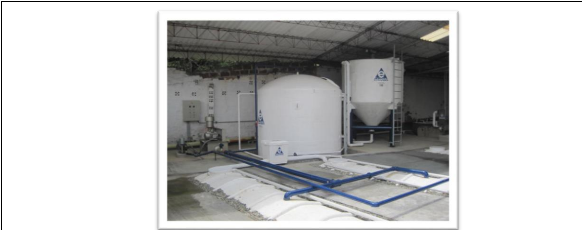
Ilustración 8. Planta de Tratamiento de Aguas Residuales Domésticas
