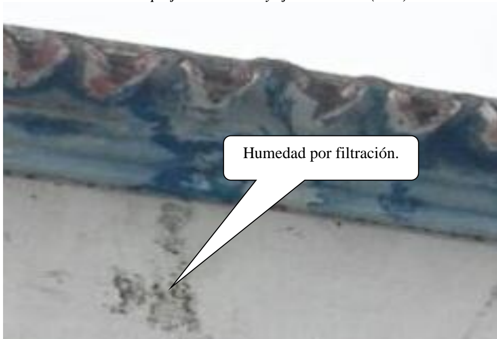
Humedad por filtración en muro y tejadillo de la casa (37-19)
