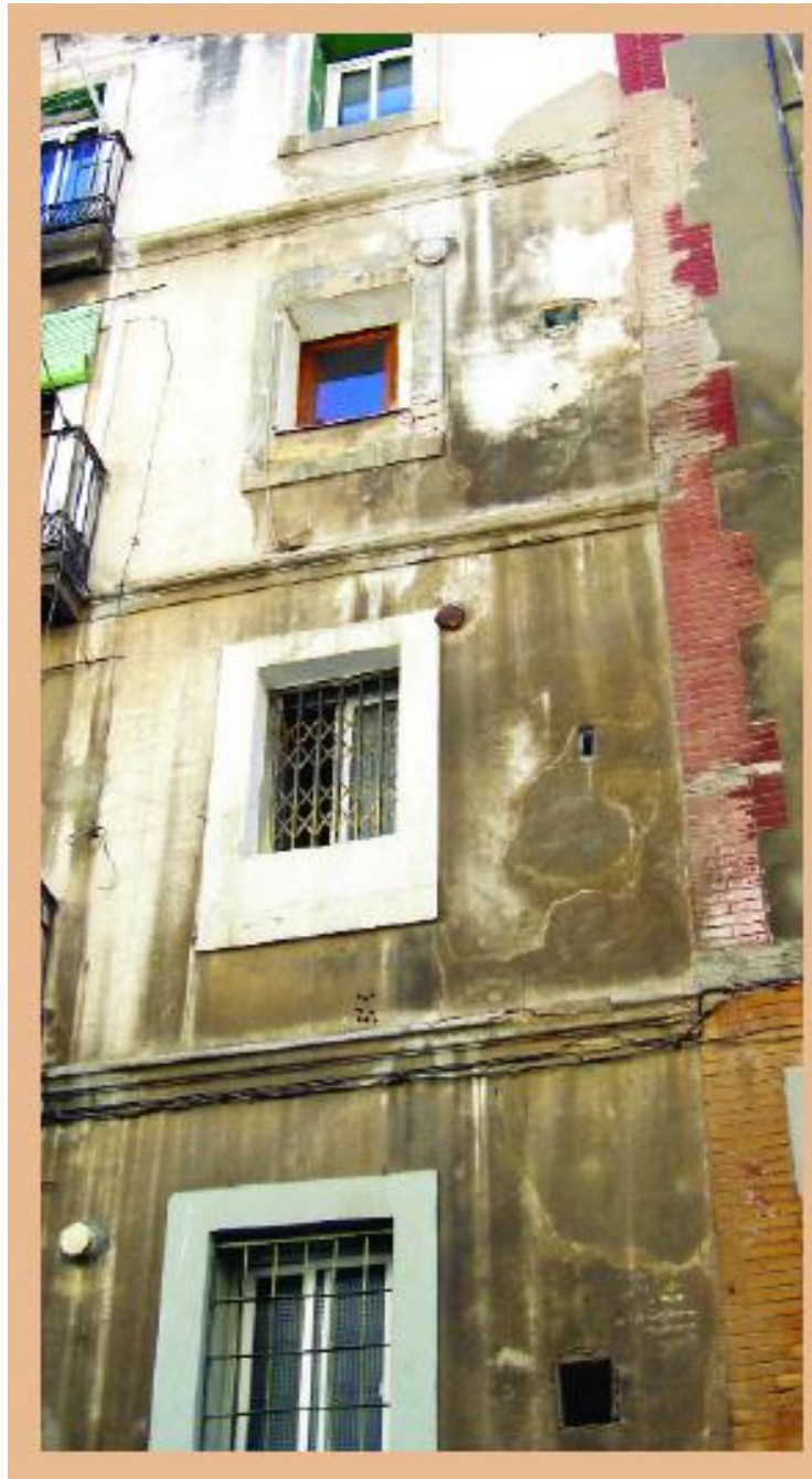
Ilustración 6 Distintas consecuencia de la retención de excesiva en muros: manchas, eflorescencias, pérdida de revoque, desconchamiento de ladrillos, expansión y pudrición de puertas y ventanas de madera.
