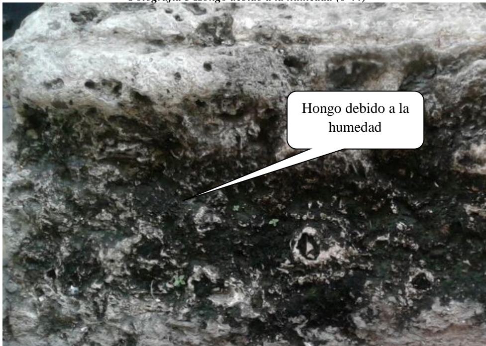
Fotografía 3 Hongo debido a la humedad (6-44)
