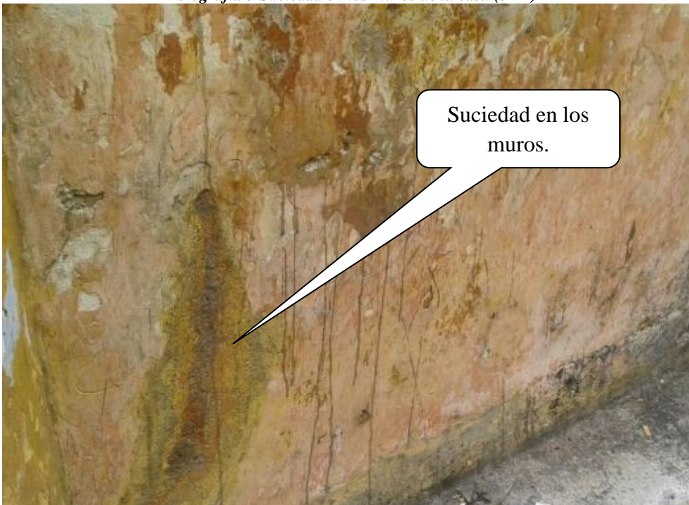
Fotografía 5 Suciedad en los muros de la casa (6-44)
