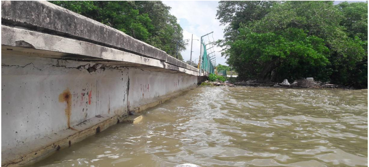
Figura 26. Viga 3 A en contacto directo con el agua de mar y con mayor concentración de cloruros
