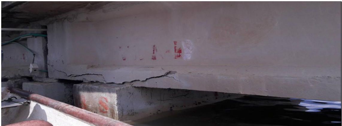
Figura 32. Vigas con presencia de grietas
