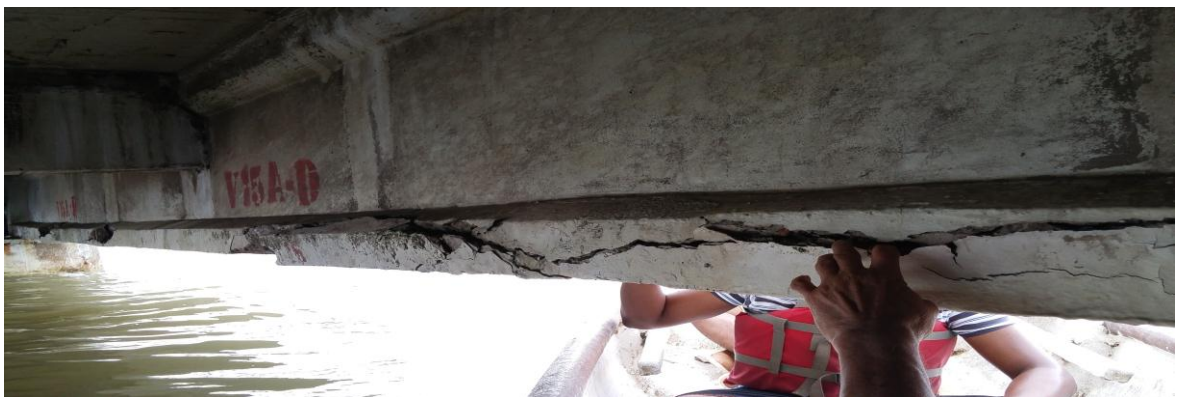
Figura 30. Viga con agrietamiento y desprendimiento de concreto
