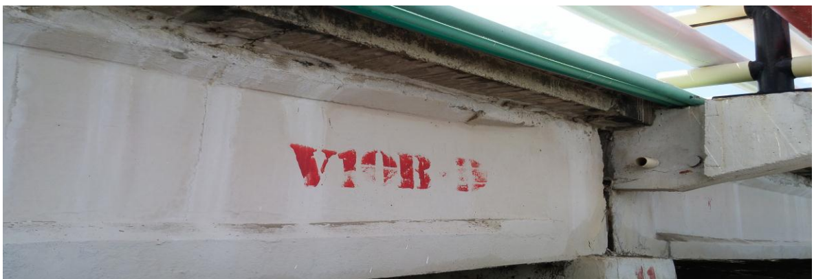
Figura 22. Viga 10 eje B con F'c bajo
