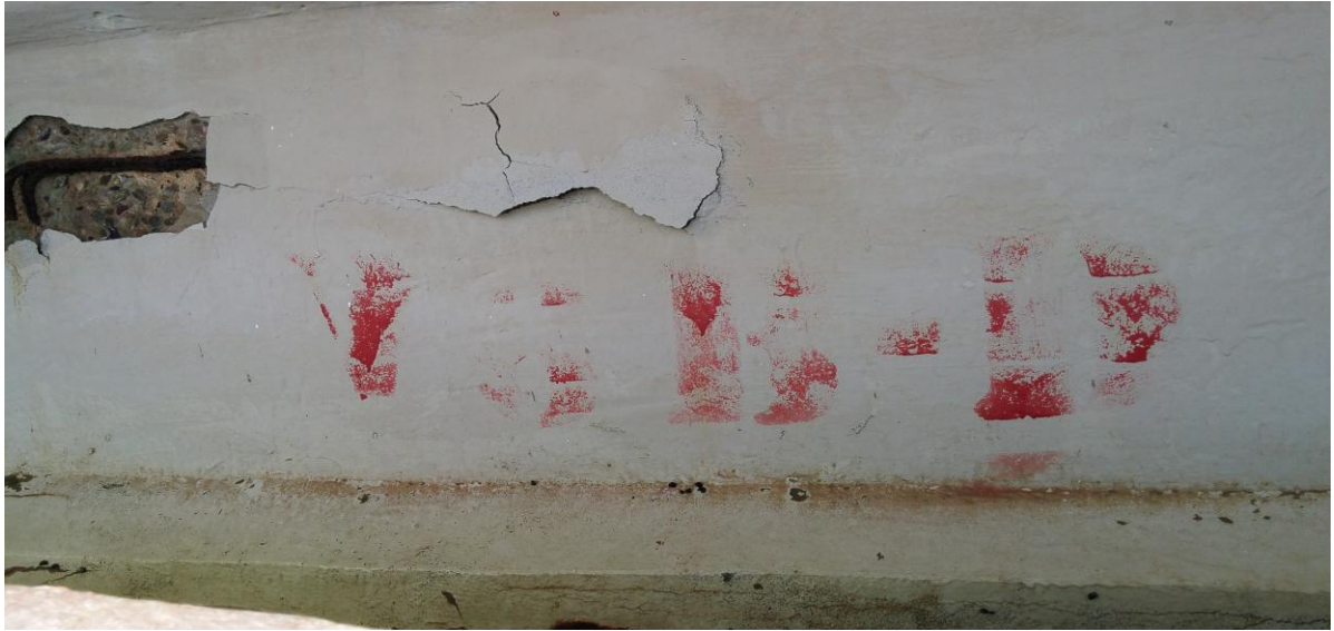
Figura 20: Viga 6 eje B lado Derecho
