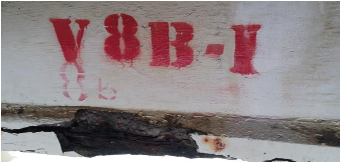
Figura 31. Viga con desprendimiento y pérdida de diámetro de la barra de refuerzo.
