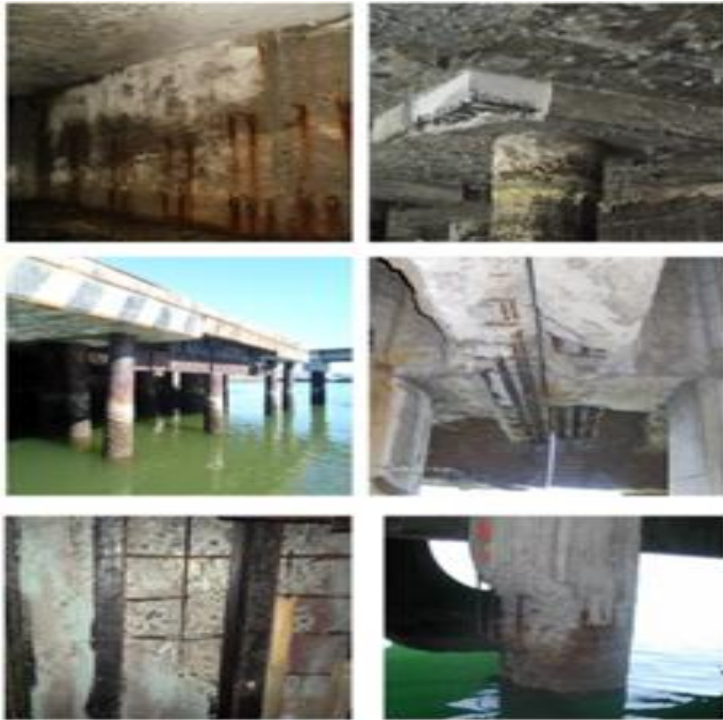
Figura 5 Daños encontrados en la inspección visual del puerto A
