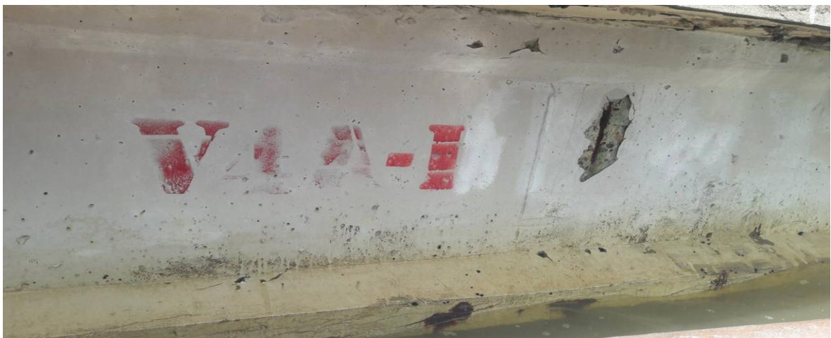
Figura 27. Viga 4 A en contacto directo con el agua de mar y con mayor contenido de cloruros
