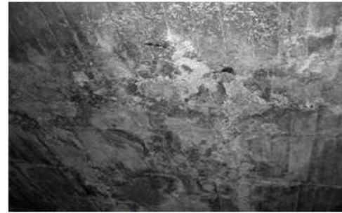
Eflorescencias en losa
