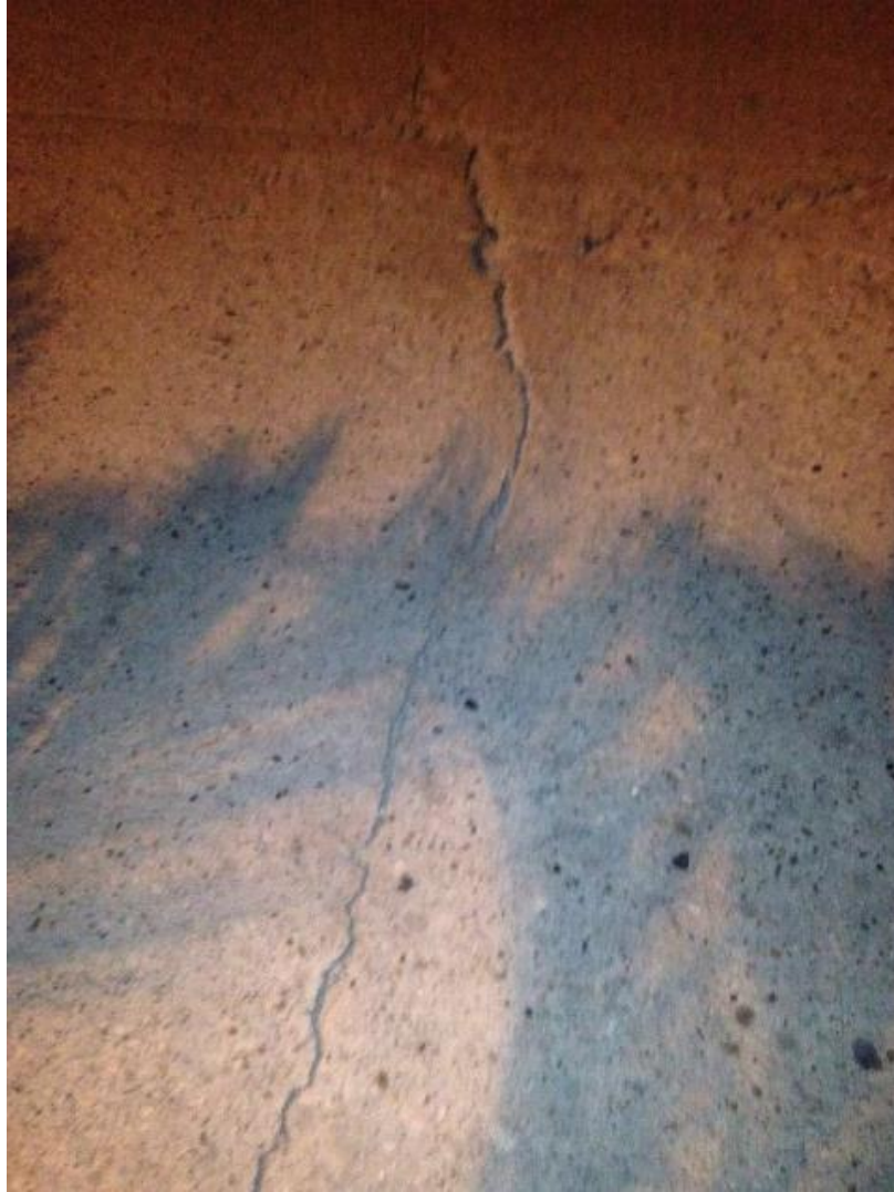
Anexo 11 Fisura transversal, Avenida Miramar
