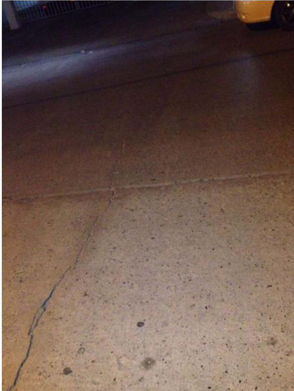
Anexo 16 Fisura transversal, Calle Real
