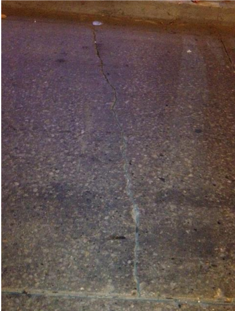
Anexo 15 Fisura transversal, Avenida Jiménez
