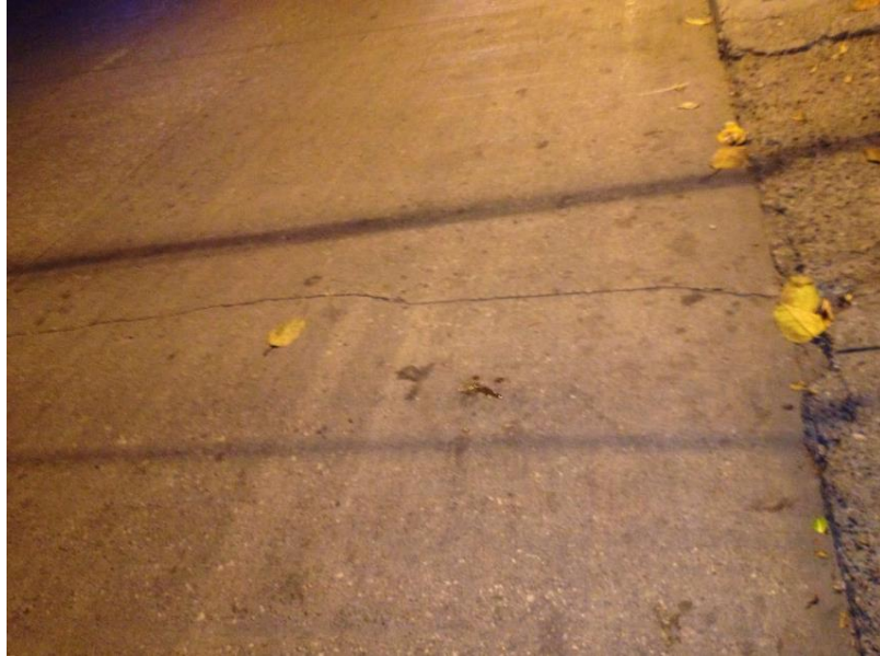
Anexo 9 Fisura transversal, Calle Real
