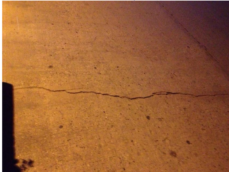
Anexo 10 Fisura transversal, Cuarta Avenida
