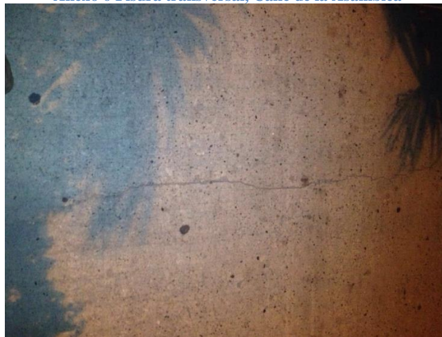
Anexo 6 Fisura transversal, Calle de la Asamblea
