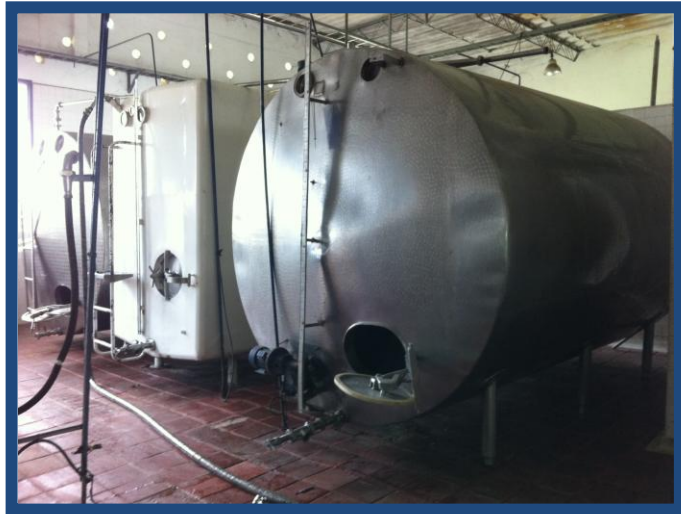
Tanques de Almacenamiento
