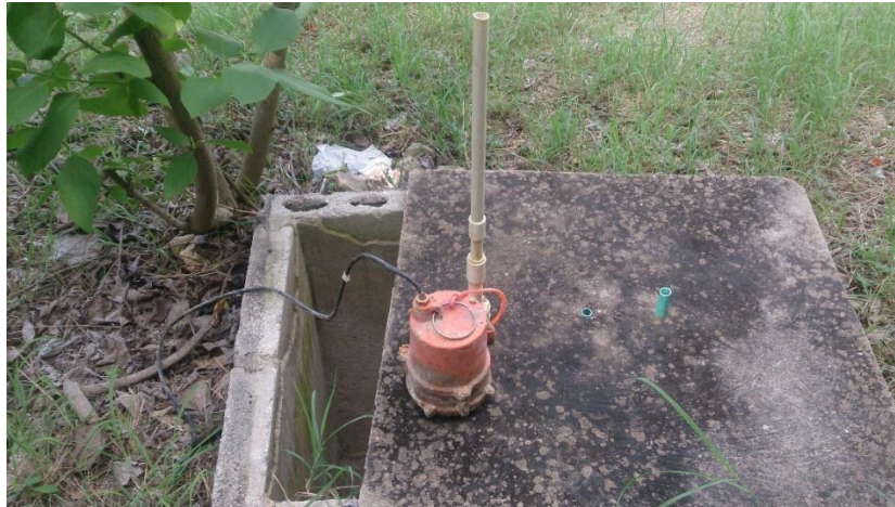
Figura 8. Registro de aguas residuales facultad de ingenierías. Fuente: Elaboración Propia.
