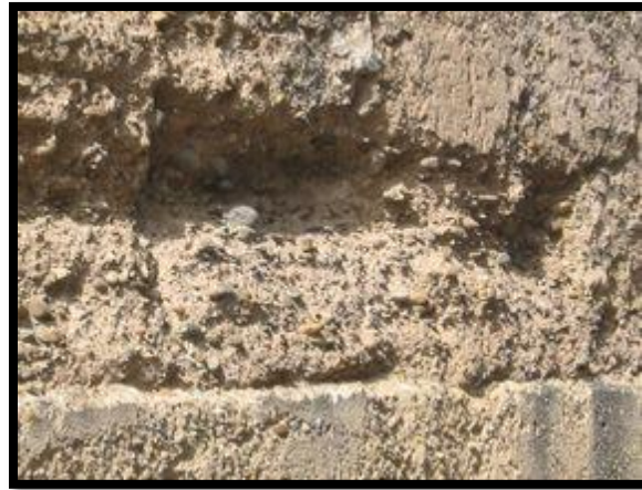
Ilustración 1 Pérdida de masa en estructura
