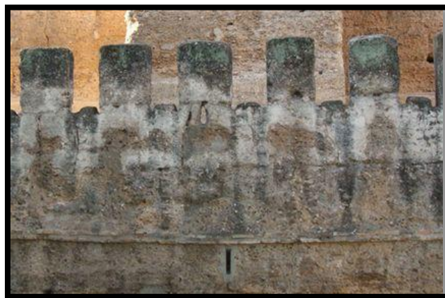
Ilustración 4- Eflorescencias presentes en una estructura
