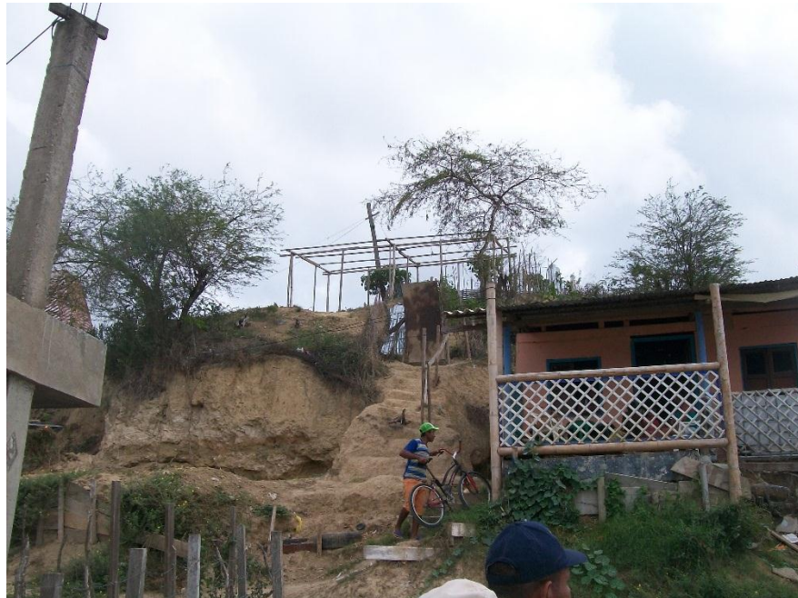
Figura 45. Erosión pluvial de talud en zona de estudio, coordenadas 10^{\circ}25'25.52''N , 75^{\circ}31'6.60''O
