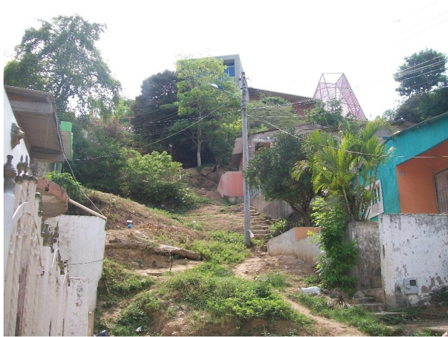
Figura 42. Erosión pluvial de talud en zona de estudio, coordenadas 10^{\circ}25'30.13''N , 75^{\circ}31'12.12''O
