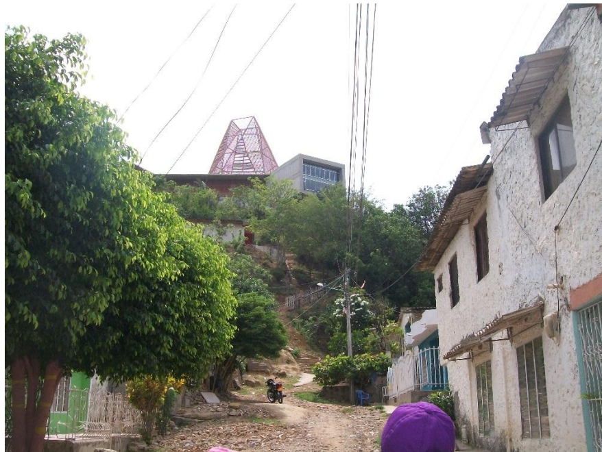
Figura 43. Erosión pluvial de talud en zona de estudio, coordenadas 10^{\circ}25'27.97''N , 75^{\circ}31'12.12''O
