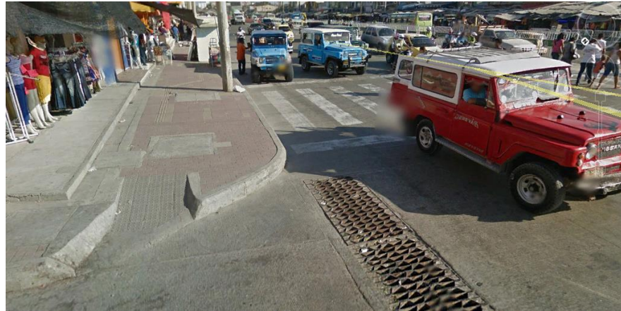
Figura 24. Sumidero de rejilla sobre arteria principal, Av. Pedro de Heredia
