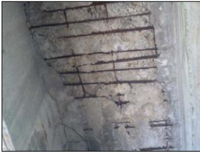
Imagen 14. Recubrimiento inadecuado en la losa, exposición del acero de refuerzo y corrosión del mismo. Puente Q. Las Ánimas, Chocó.
