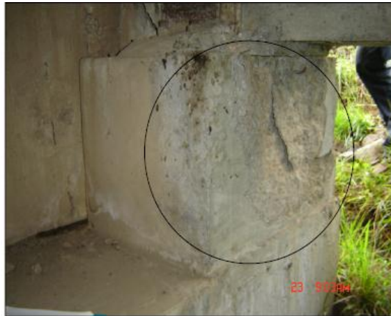
Imagen 7. Fractura por aplastamiento en el pedestal. Puente Cañada Profunda.
