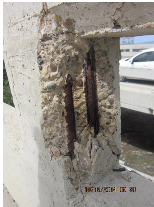
Imagen 28. Prueba de Carbonatación en Barandas.
