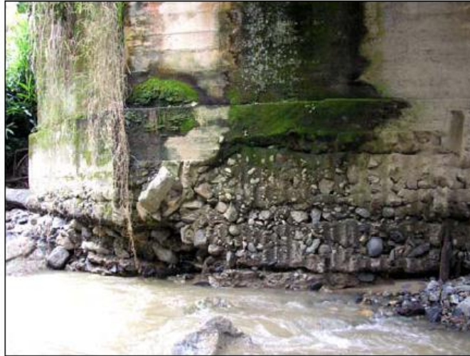
Imagen 19. Socavación en un estribo. Puente Meldar, Tolima.
