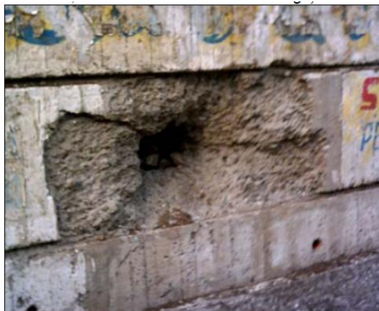
Imagen 18. Fracturamiento del concreto y pérdida de la sección por impacto de un objeto. Muro de Contención, Carretera Buenaventura-Buga.
