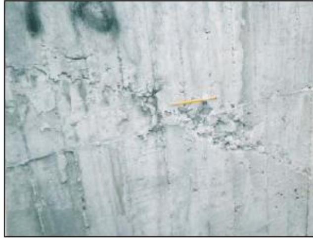
Imagen 13. Junta fría construida inadecuadamente.
