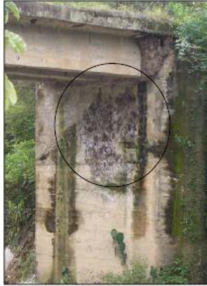
Imagen 15. Presencia de eflorescencias en el estribo del puente. Puente Río Meldar, Tolima.
