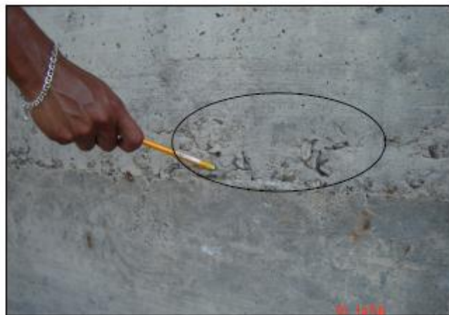
Imagen 11. Segregación en un muro. Vía Simití- Centro de Burgos, Bolívar.
