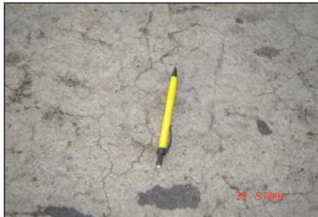
Imagen 12. Fisuración por retracción hidráulica. Puente Luis Ignacio Andrade, Tolima.
