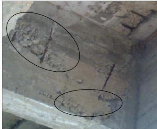
Imagen 10. Presencia de hormigueros en la viga cabezal. Puente Río Meldar, Tolima.
