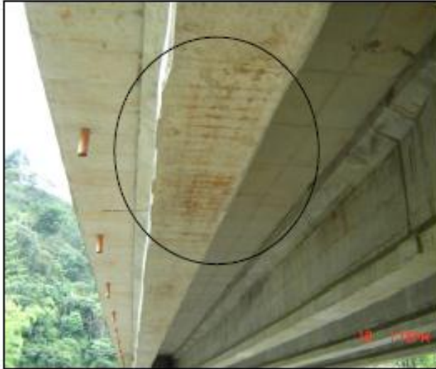
Imagen 16. Evidencia de manchas de óxido en la superficie del concreto. Puente sobre el Río Quindío.
