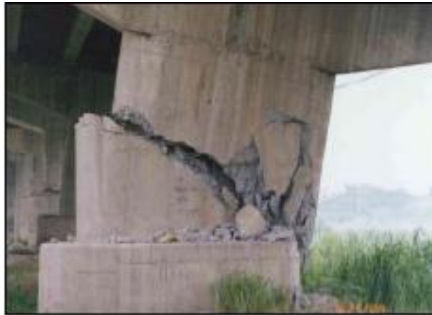
Imagen 4. Fractura por cortante en la Pila. Puente U Shi. Taiwan
