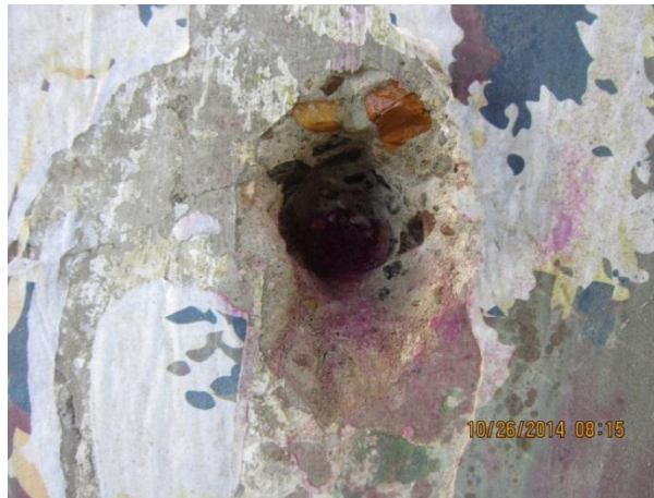
Imagen 26. Prueba de Carbonatación en Pila de la calzada 3.
