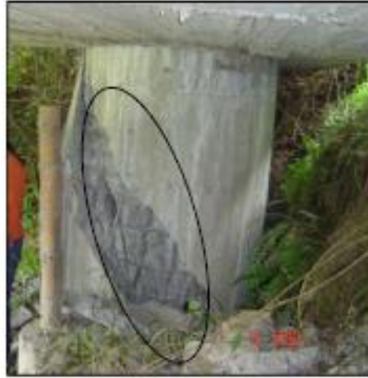
Imagen 6. Fisuración por Torsión de una Pila. Puente sobre la Quebrada Marmato, Caldas.
