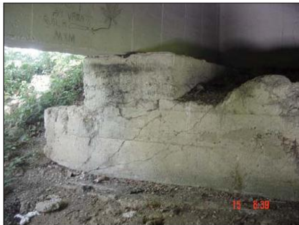
Imagen 8. Fracturas por aplastamiento en la viga de cimentación. Puente
