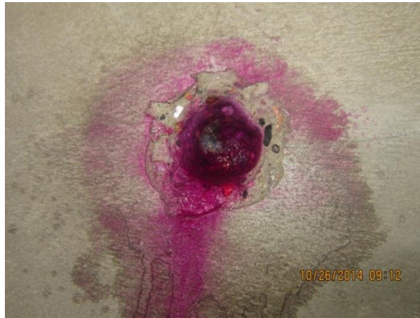
Imagen 27. Prueba de Carbonatación en la superficie de la viga de la calzada 1.
