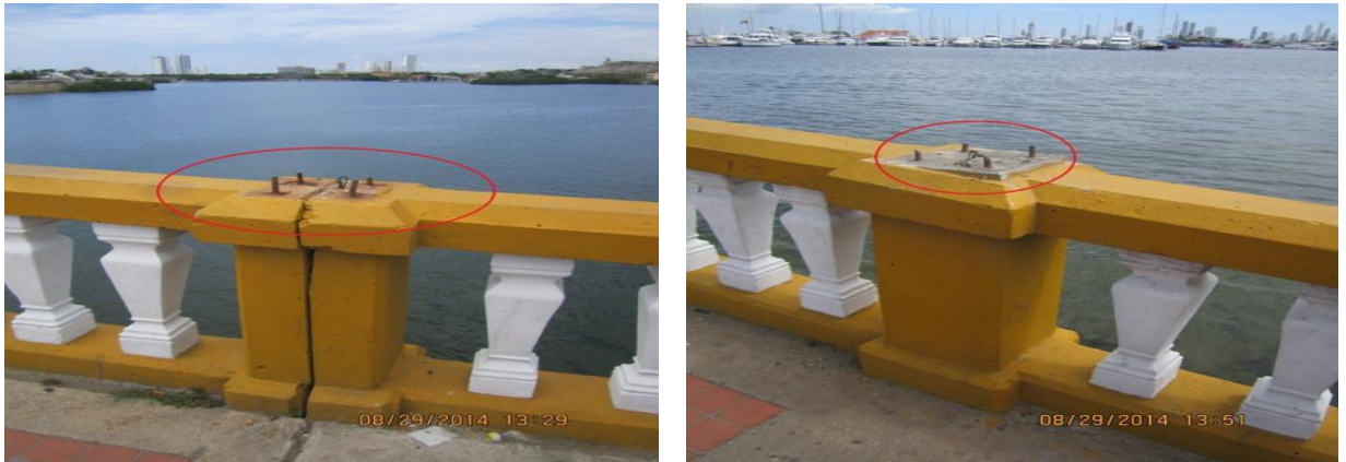
Fotografía 8. Ausencia de iluminación en varios puntos.
