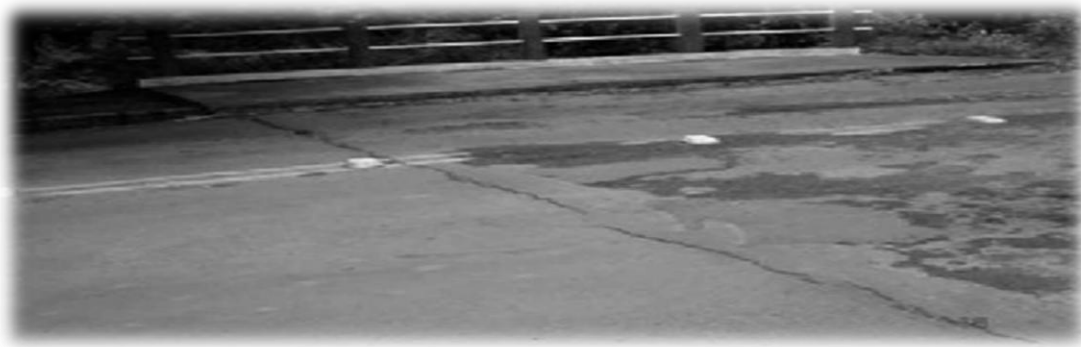
Imagen 3. Fotografía de las grietas en las juntas y deterioro del pavimento.
