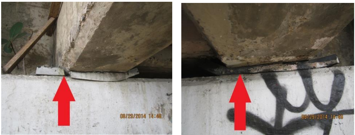
Fotografía 11. Elementos de enlace en placas de neopreno en precarias condiciones.
