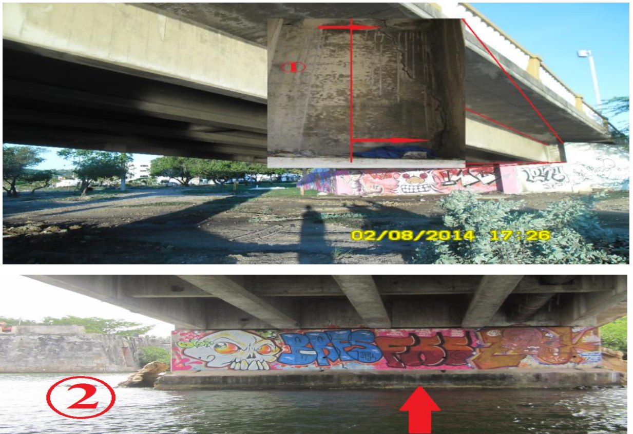
Fotografía 12. En el estribo número 1, se evidencia una grieta de 45°, en el estribo 2 se ven eflorescencias por ciclos de humedecimiento y secado.
