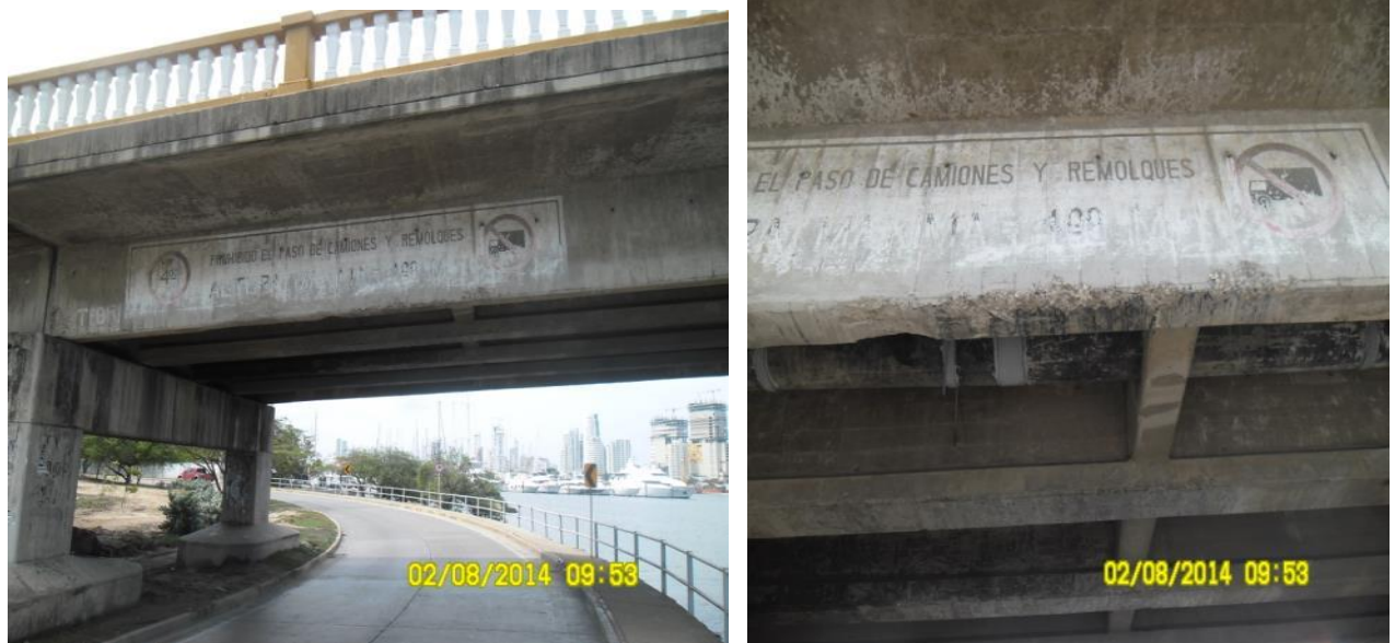
Fotografía 3. Falla por impacto de vehículo en segunda luz del Puente.
