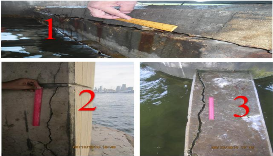
Fotografía 13. En 1 se ve una gran grieta en la viga de amarre del pórtico 2, en 2 se notan grietas verticales en las columnas de los pórticos y en 3 se ve una grieta considerable en la viga de amarre del pórtico 4.
