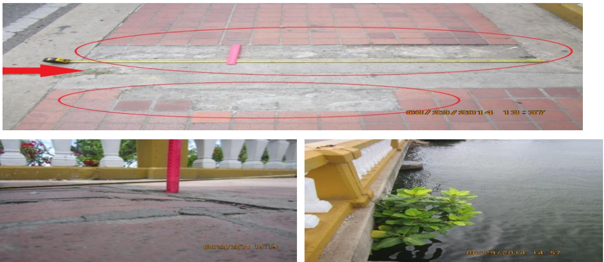
Fotografía 6. Desnivel y falta de baldosines en los andenes & presencia de vegetación en la superestructura
