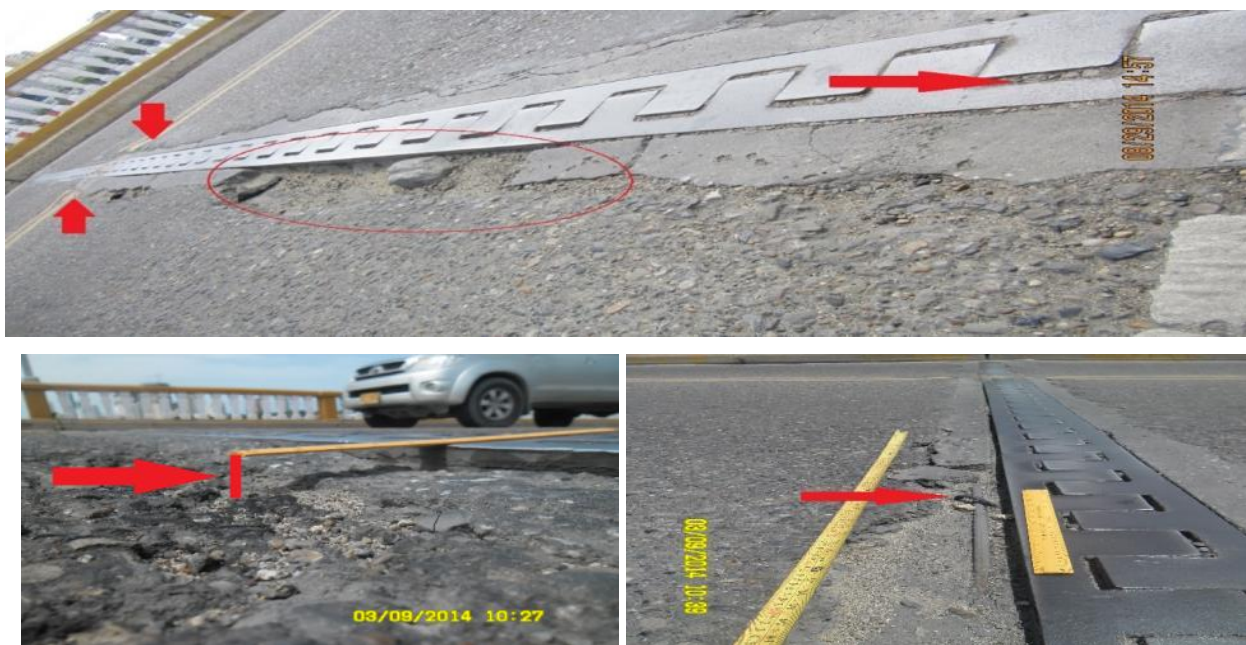
Fotografía 5. Deterioro de los guardacantos y juntas de expansión.
