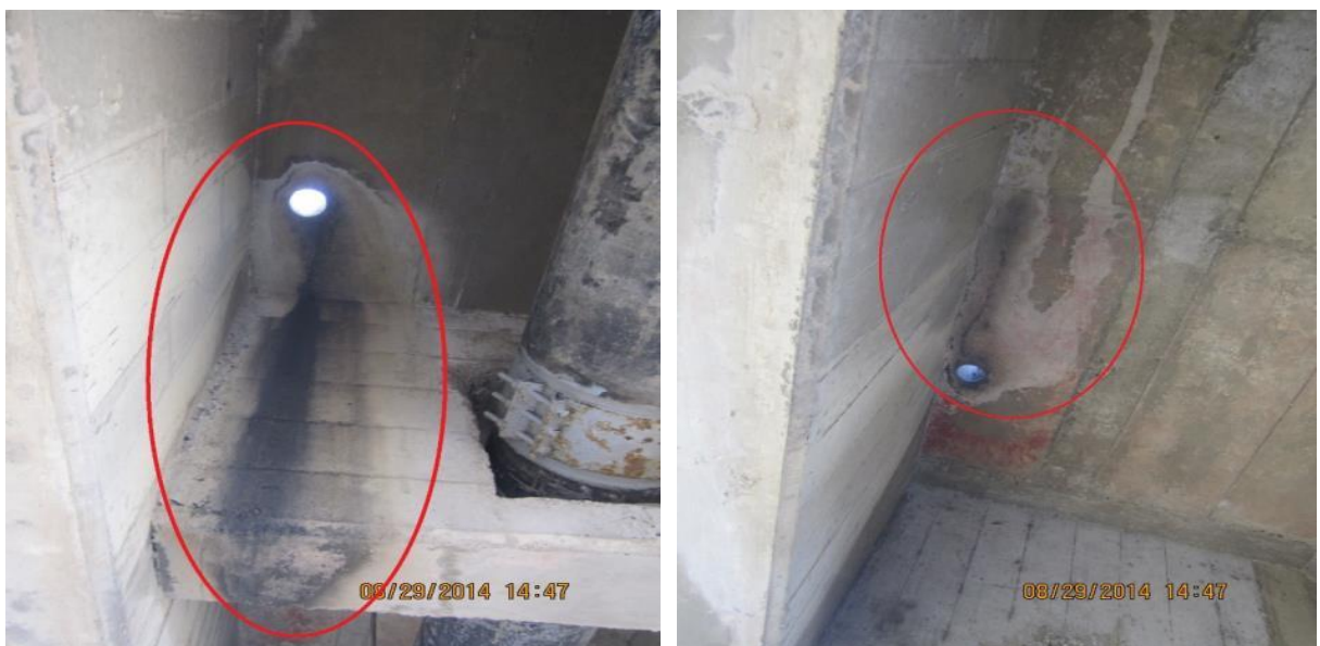
Fotografía 10. Drenajes mal contruidos
