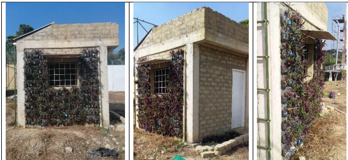
Ilustración 32. Muro verde con Barquillo Morado, ubicado en la fachada Este. Fuente: (Barón & Navarro, 2020).
