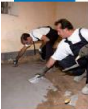
Aplicación con llana de la primera capa de Planitop HDM Restauro en el extradós de una bóveda
