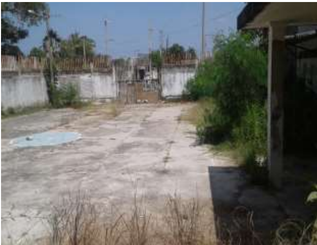
Imagen 2. Deterioro de las estructuras. Fuente: Elaboración propia, 2021.
