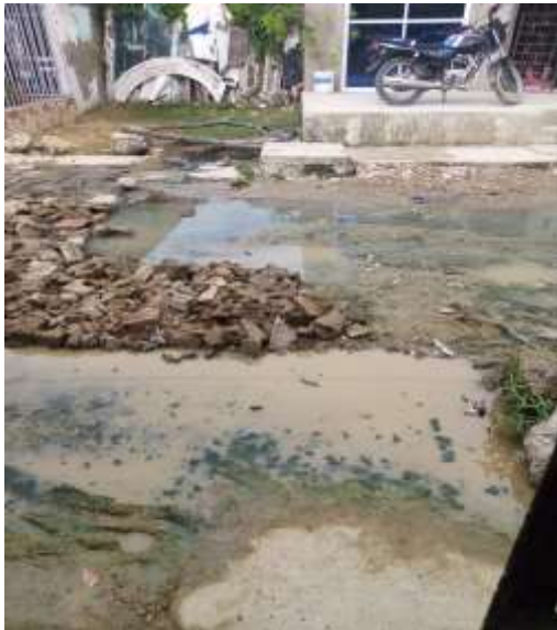
Imagen 4. Calle en mal estado. Fuente: Estudiante del grado 9° de la I.E. San Felipe Neri.
