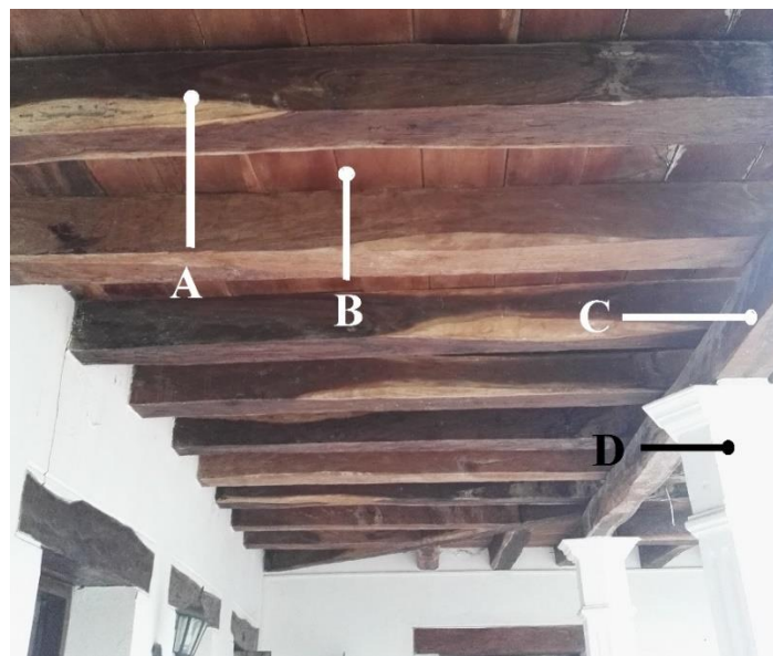
Figura 15. Cubierta Plana en Terraza, Corporación Unificada Nacional de Educación Superior (CUN). Fuente: Autores
