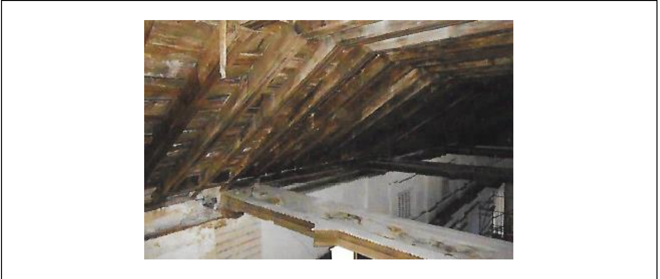
RECuento FOTOGRÁFICO No. 5. Humedades observadas en el artesonado por infiltraciones de agua lluvia. (2013)
