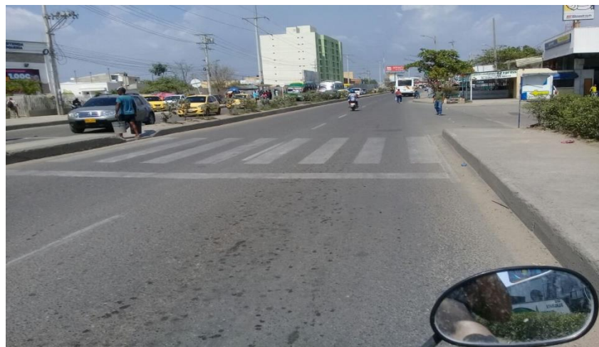
Figura 8. Estado de la vía Frente a la Terminal del Transporte.
