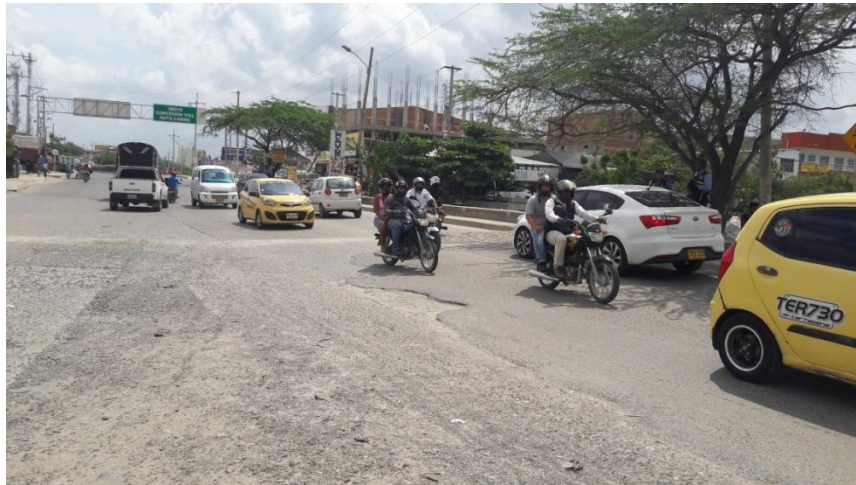
Figura 7. Estado de la vía Frente al barrio las Palmeras.
