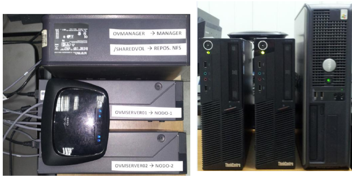
Ilustración 4: Conexiones Físicas y maquinas hardware componentes del Clúster
