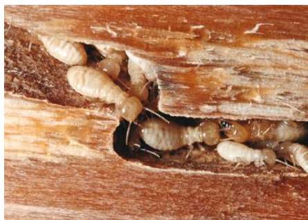
Figura 13. Termitas deteriorando pieza de madera Fuente: (Ecoespacio, 2010).
