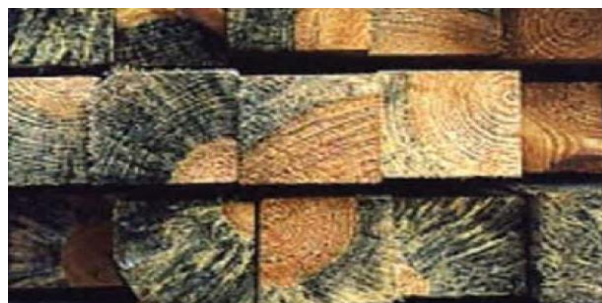
Figura 8. Degradación de la madera Fuente: (Centro de transferencia tecnológica de la madera, 2007).
