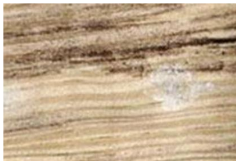
Figura 12. Pieza de madera atacada por Moho Fuente: (Fritz, 2010)
