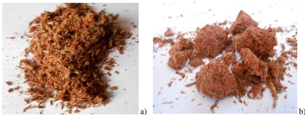
Figura 31. a) Viruta de Abarco en mal estado; b) Testigos de Abarco en mal estado. Fuente: Los Autores.
