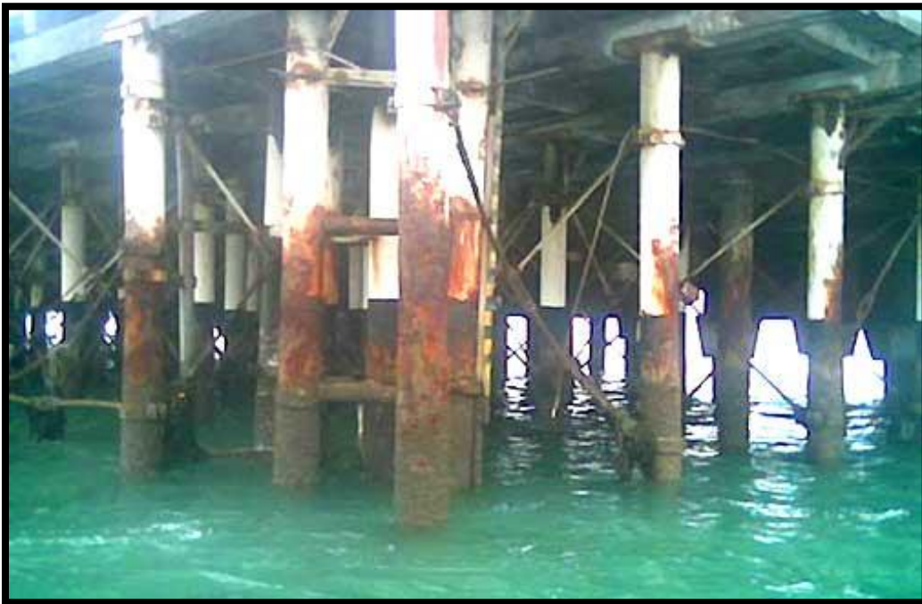
Anexo 4. Corrosión galvánica
