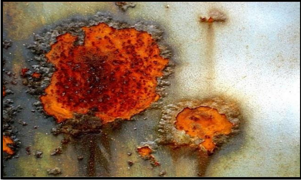
Anexo 5 Corrosión por picadura
