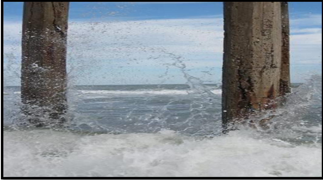
Anexo 1. Corrosión por deterioro uniforme o general
