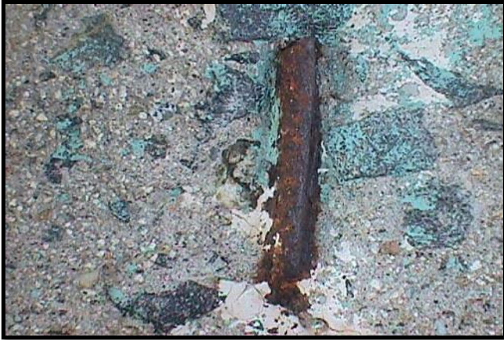
Anexo 3. Corrosión galvánica
