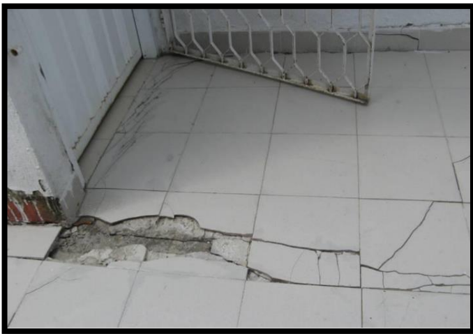
Ilustración 29. Agrietamiento estructural del suelo en la parte exterior de una vivienda en el barrio El Rodeo. (Carvajal & Calderon, 2013)
