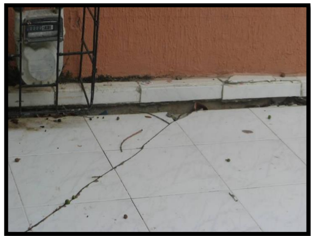
Ilustración 30. Hundimiento del suelo de vivienda, reflejado en la base de la pared de esta. (Carvajal & Calderón, 2013)
