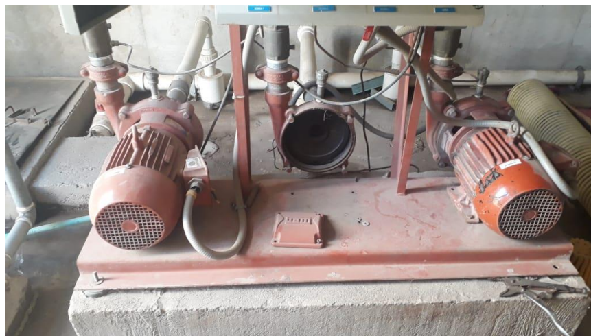
Fotografía 2. Hidrobomba de la manzana “Mis Muchachitas” en mal estado. Por: Orozco, 2019.
