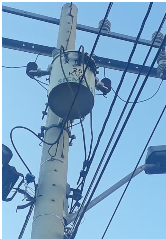
Fotografía 3. Transformador en mal estado. Por: Orozco, 2019.
