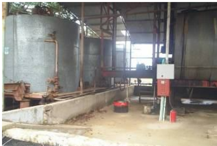
Ilustración 9. Tanques de almacenamiento de asfalto
